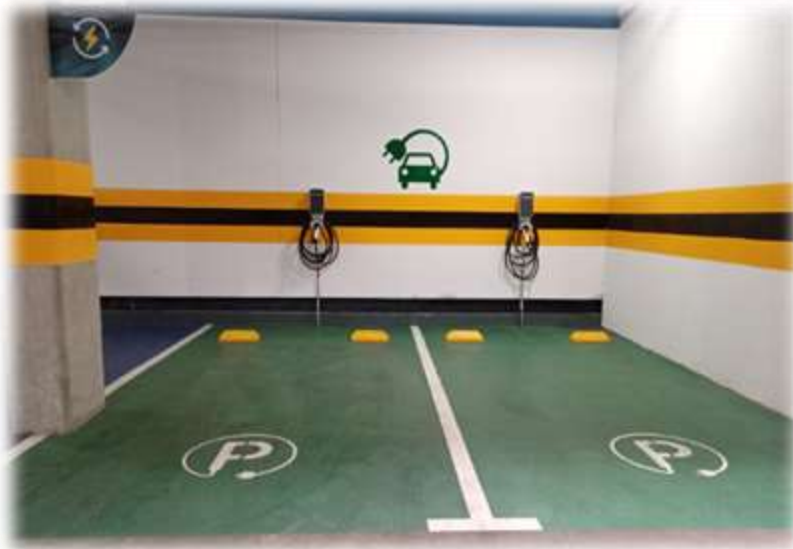
Servicio de carga para vehículos eléctricos.
